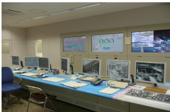
平瀬浄水場 操作室
