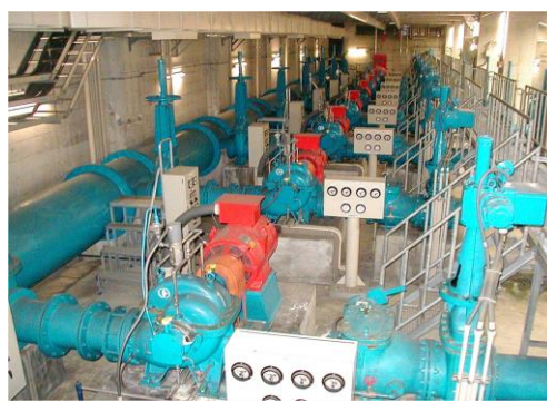
昭和浄水場 ポンプ室
