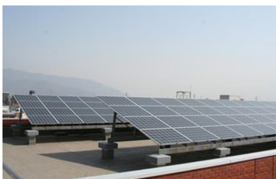
太陽光発電の導入（上下水道局庁舎）
