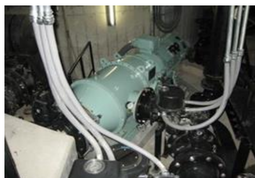
小水力発電の導入（山宮減圧槽）
