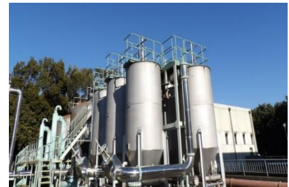
砂ろ過塔（処理水の再利用）
