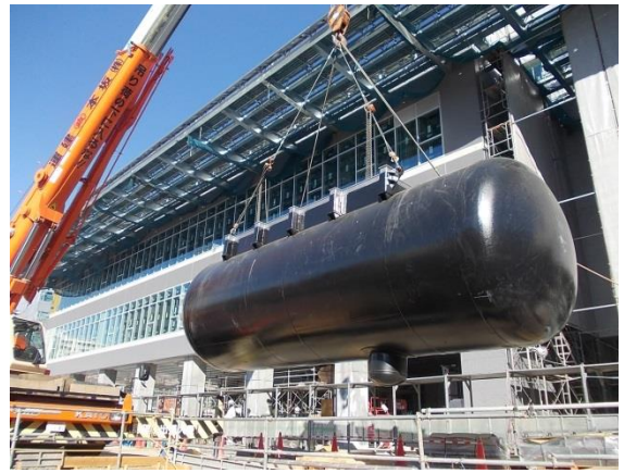
非常用貯水槽※
