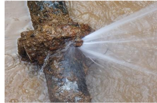
【老朽化した管路】
