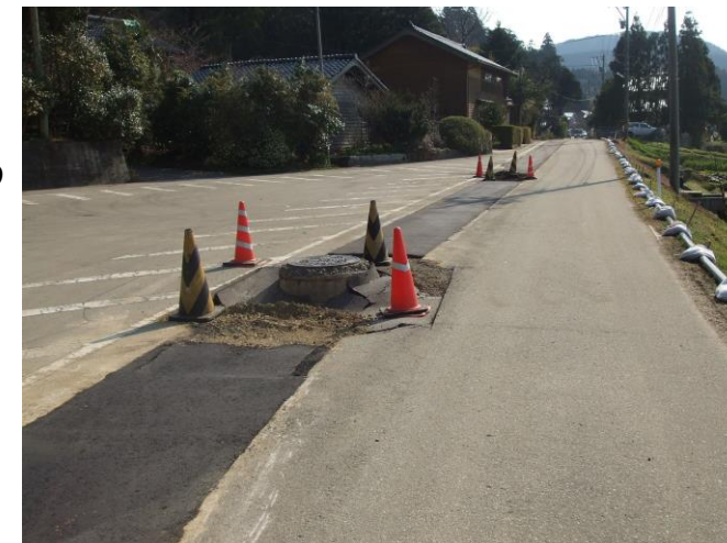
【浮上したマンホール】
