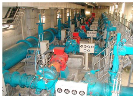
昭和浄水場 ポンプ室
