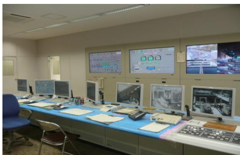
平瀬浄水場 操作室
