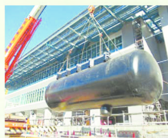
非常用貯水槽(甲府市役所本庁舎)
