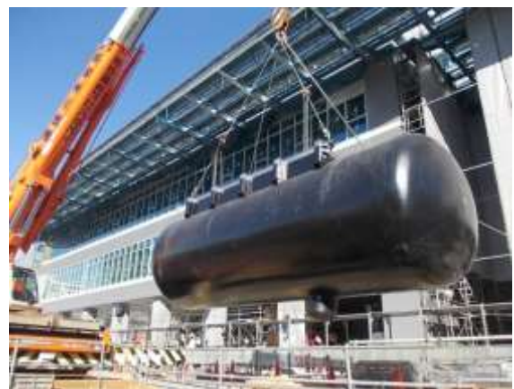
非常用貯水槽
