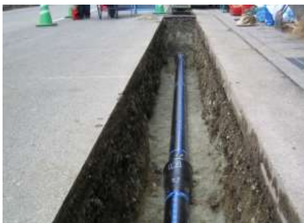
管路の耐震化
