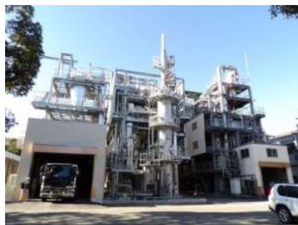
甲府市浄化センター汚泥焼却施設
