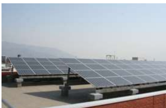
太陽光発電の導入（上下水道局庁舎）
