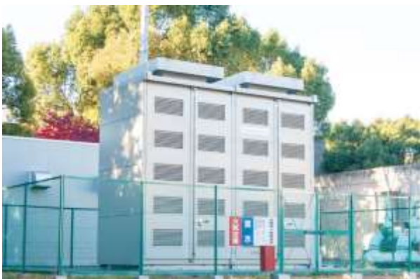
甲府市浄化センター「ナトリウム・硫黄電池」
