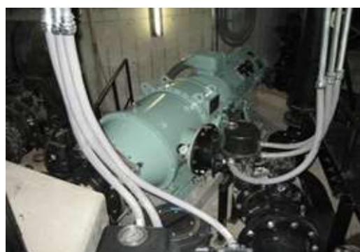
小水力発電の導入（山宮減圧槽）
