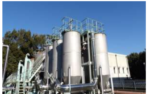
砂ろ過塔（処理水の再利用）
