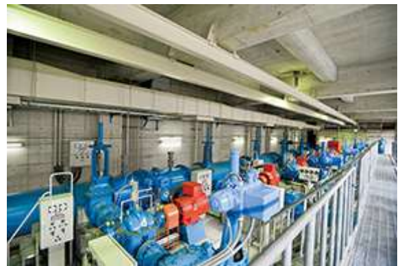
昭和浄水場送水・配水ポンプ
