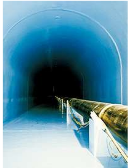
平瀬系送水管 （湯村山トンネル配水池）
