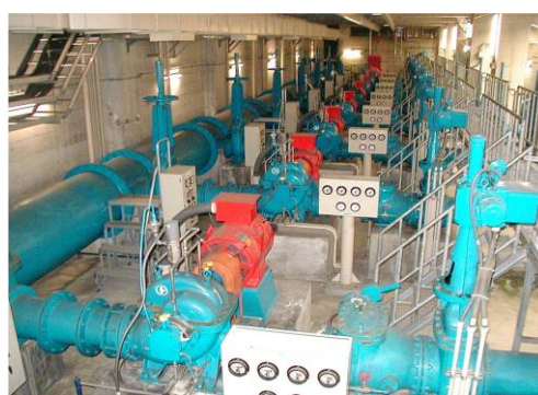
昭和浄水場 ポンプ室
