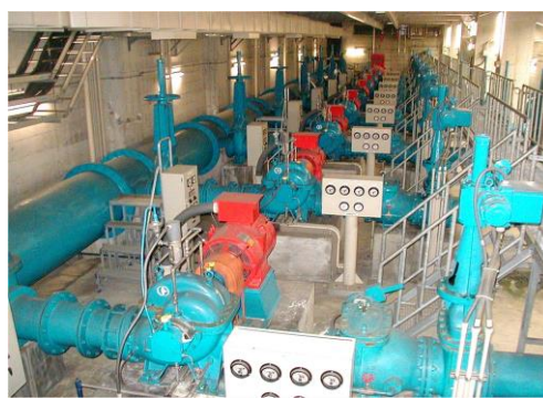
昭和浄水場 ポンプ室
